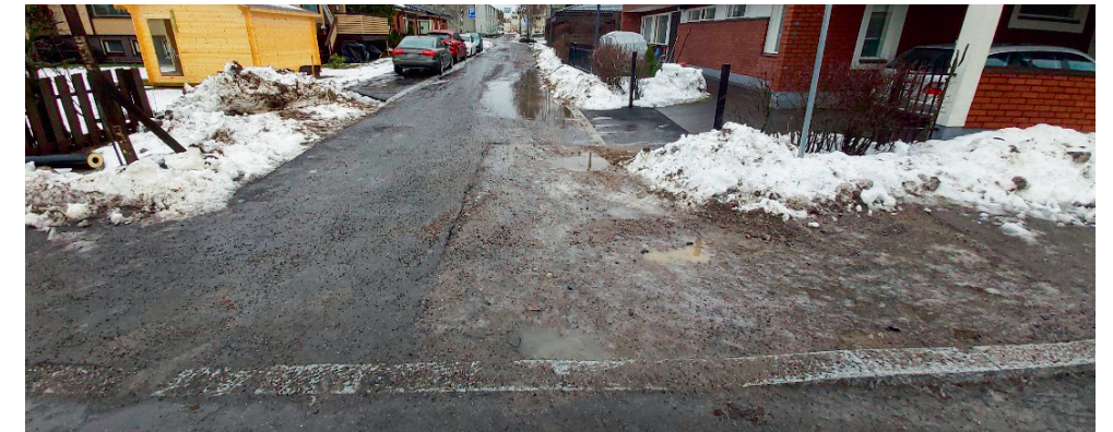
Kisapolku 30.1.2023. Lumenaurauksien jälkeen sora on levinnyt pitkin katuja ja asfaltoimaton kohta syventynyt.
